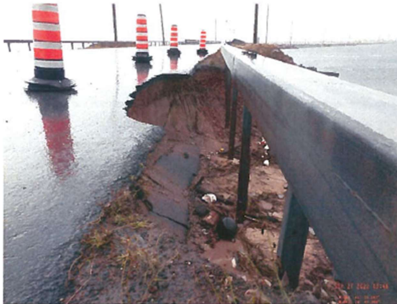
FIGURE 3 DOMMAGES OBSERVÉS À LA SUITE DU PASSAGE DE L'OURAGAN FIONA LES 23 ET 24 SEPTEMBRE 2022
