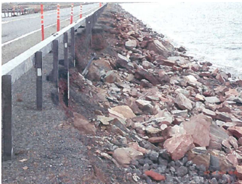
FIGURE 2 DOMMAGES OBSERVÉS À LA SUITE DU PASSAGE DE L'OURAGAN FIONA LES 23 ET 24 SEPTEMBRE 2022
