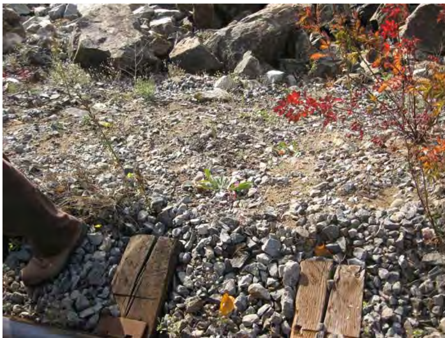
Érosion au point milliaire 68.7 près de Les Éboulements. Noter la présence importante de sable dans le matériau de fondation.
