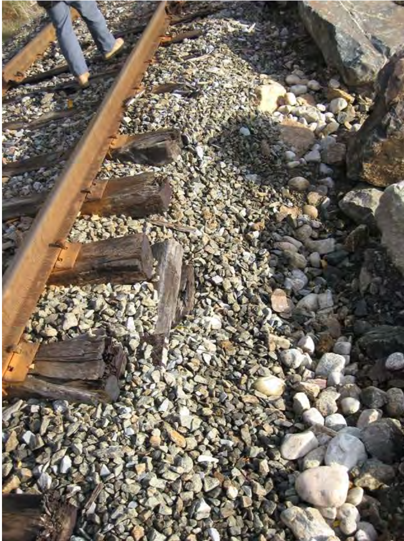
Érosion au point milliaire 76.15 près de Saint-Irénée
