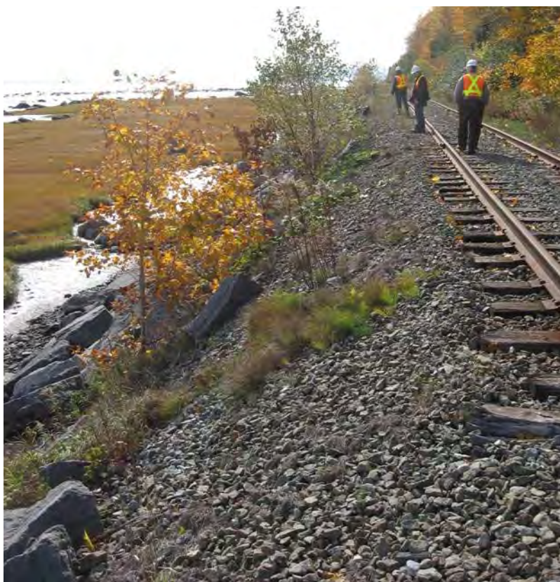
Érosion au point milliaire 50.55 à l'est de Petite-Rivière- Saint-François.
